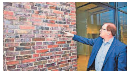
Prüfender Blick vom Gemeindebürgermeister Axel Renken: Der Torfbrandklinker passt zu Gnarrenburg – und zum Bürgerhaus.
